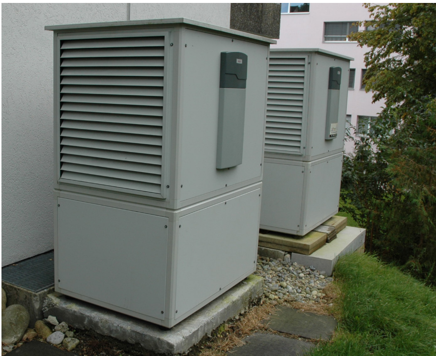
Abbildung 7: Luft-Wasser-Wärmepumpen generieren einen steten Lärmpegel und sind bewilligungspflichtig.
